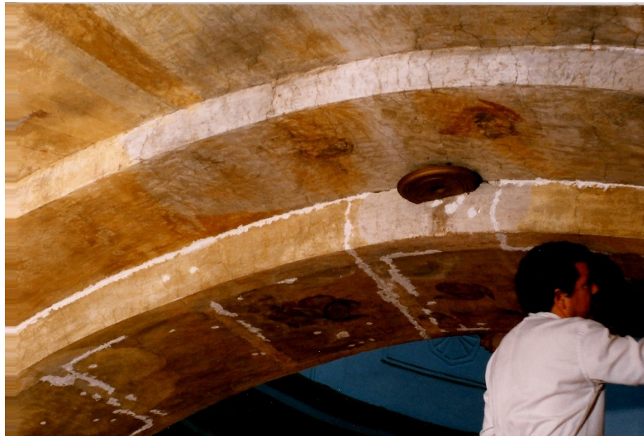
Figuras 140 y 141. Raspones de poca profundidad y estucado de grietas
